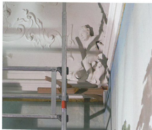
8 Nordostecke des Saals: Eine am Gerüst angebrachte Konstruktion aus Kartonage dient zum Andrücken beim Neufixieren abgelöster Tapetenstücke, Aufn. 2018.
