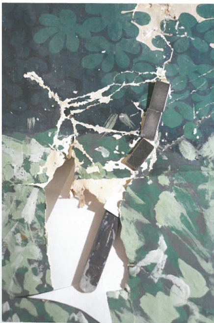
13 Detail der Nordwand mit einem etwa 5 x 9 cm großen Loch im Bereich des Übergangs zwischen gemalter und gedruckter Tapete. Links: Die Risse werden mit Hilfe von Magneten verklebt. Mitte: Das Loch wurde durch das Einsetzen von zwei Kartonstücken geschlossen. Rechts: Die Fehlstelle nach der Retusche. Aufn. 2018.
