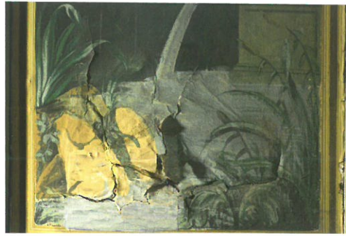
14 Südwand, rechte Seite: schmale Bahn mit Landschaftsdarstellung, Zustand nach der Restaurierung, Aufn. 2020.
